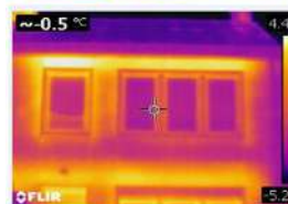
FOTO BOVENZIJDE VOORGEVEL: boven ramen zijn warmteverliezen
