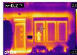
FOTO ONDERZIJDE VOORGEVEL: boven de deur en ramen zijn warmteverliezen waarneembaar
